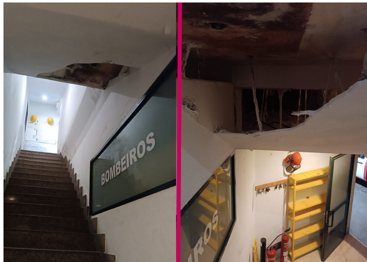
Instalacións do GES do Val Miñor
